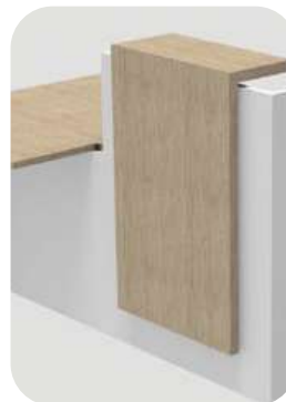
Parement installé sans entretoise
